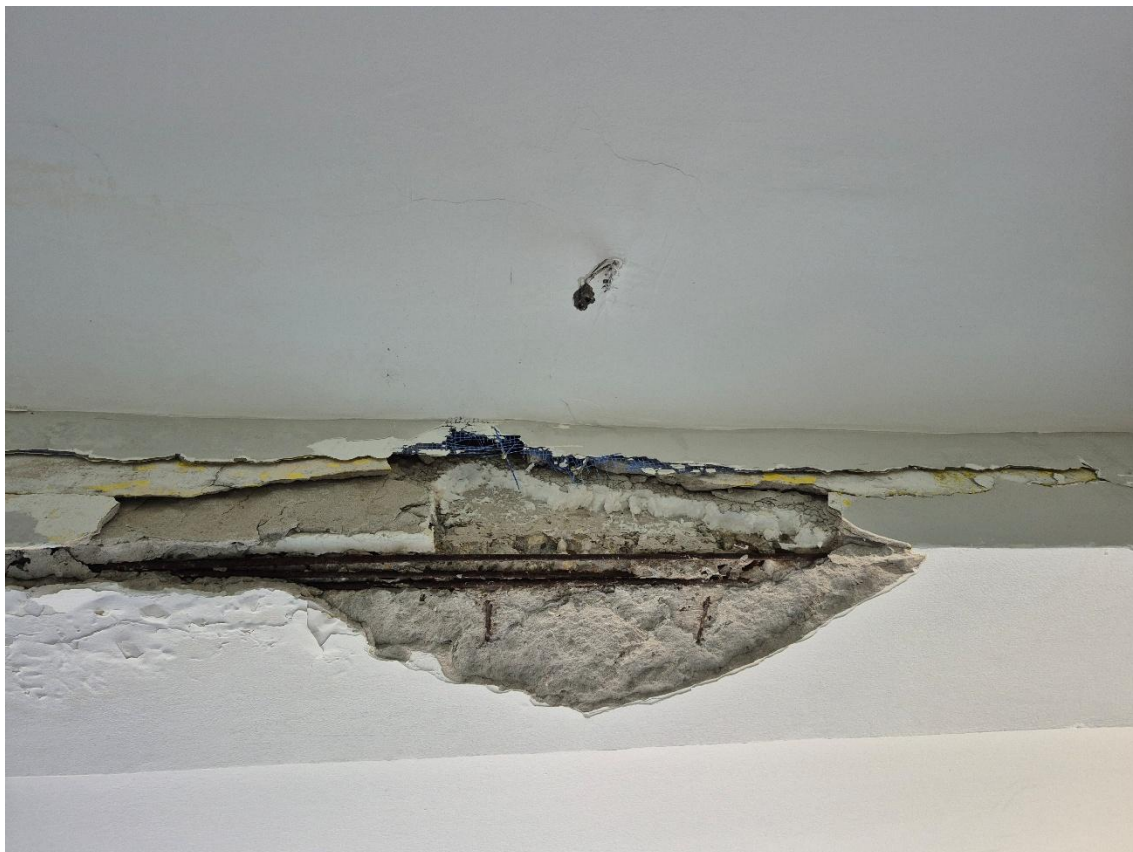
Слика 3.29. Детаљнији приказ зоне пукотине након скидања дела облоге
