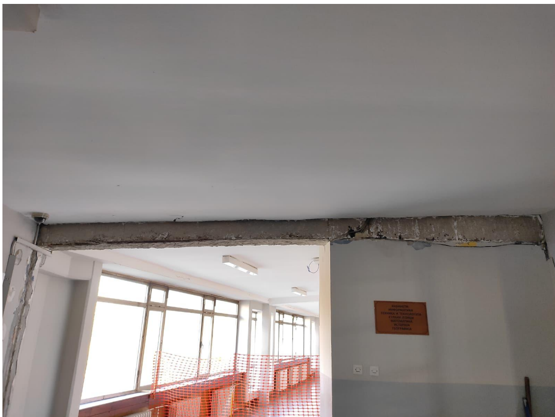
Слика 3.30. Приказ греде са стране степенишног хола након скидања облоге
