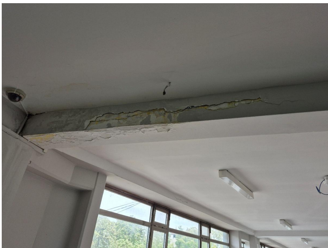
Слика 3.26. Шири приказ пукотина на облози греде
