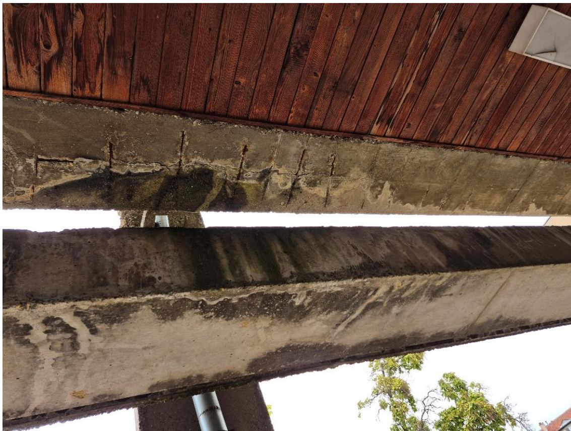
Слика 3.21. Уочена је недовољна дебљина заштитног слоја бетона на греди на тераси и видљиве кородирале узенгије са доње стране греде
